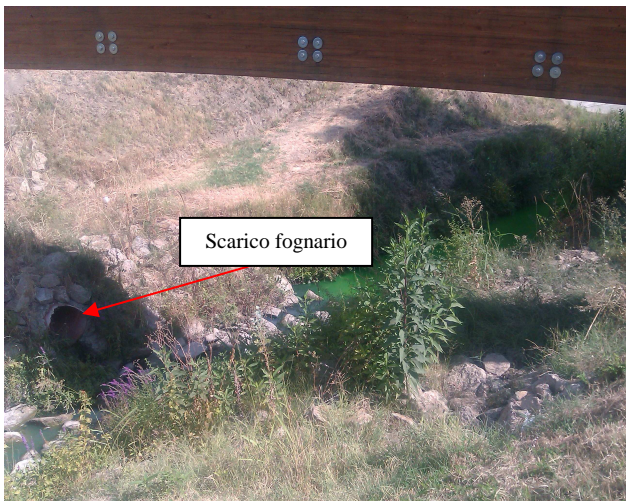
Foto 5 Particolare posizione dello scarico fognario acque bianche sotto il ponticello ciclo pedonale via di Benati/Calanchi.
