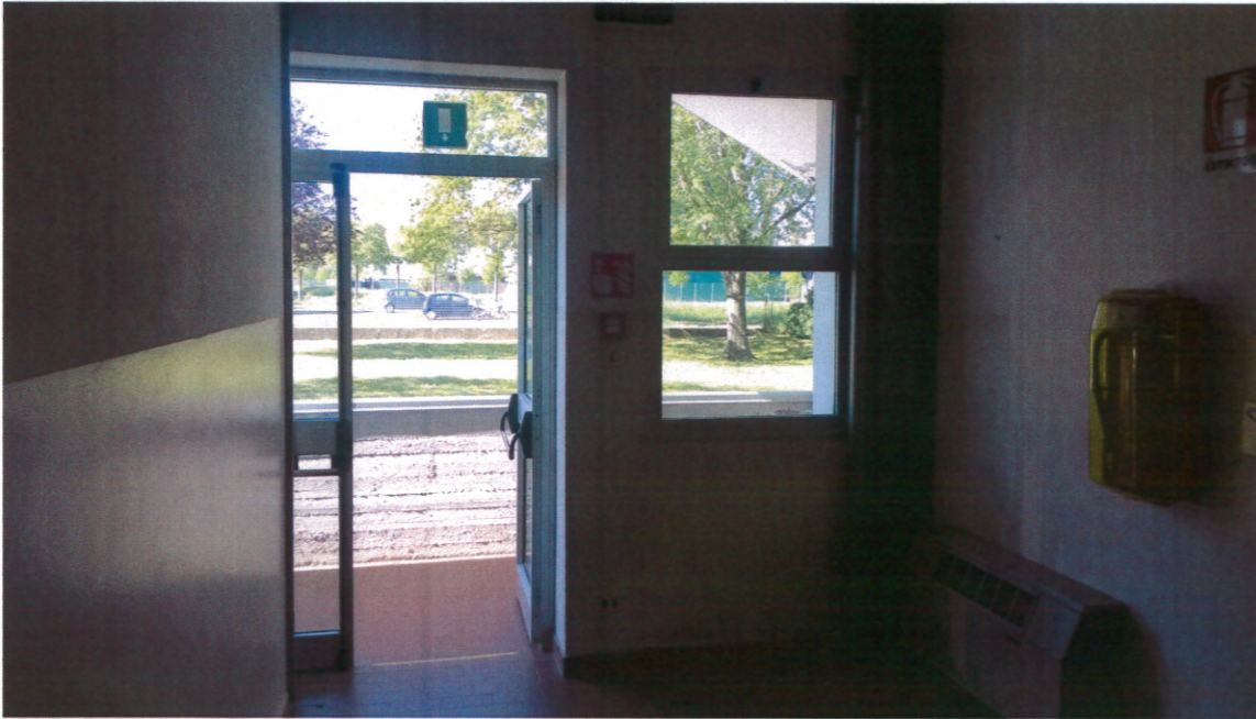
Uscita di emergenza da allargare e sostituire l'infisso
