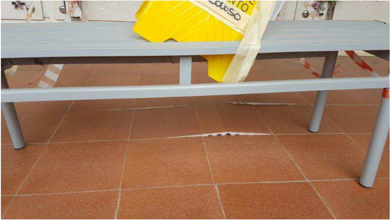
PAVIMENTAZIONE ROTTA GALLERIA PARTE NUOVA CIMITERO
